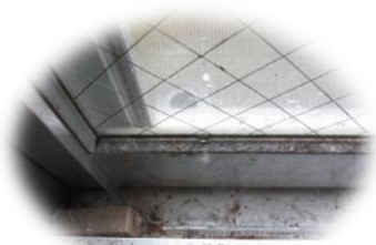
サッシレールが汚い
